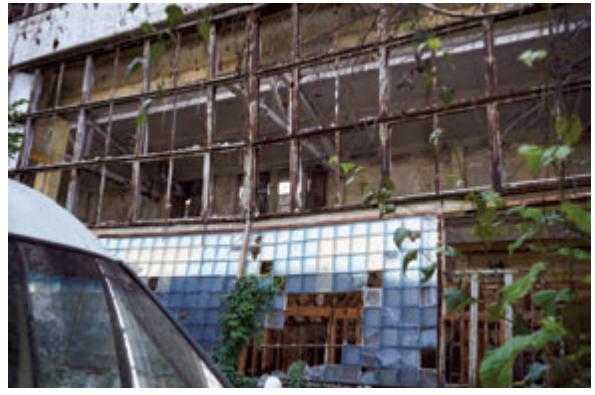
Будівля Інституту надтвердих матеріалів ім. В.М. Бакуля НАН України після обстрілу, Київ
