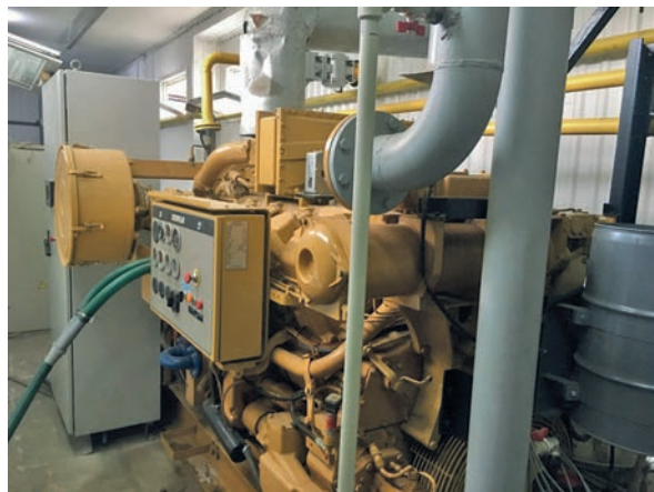
Генераційне обладнання (електрична потужність 500 кВт)
