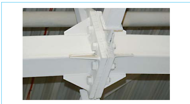
Сталева конструкція, оброблена інтумесцентним покриттям ІК-6
