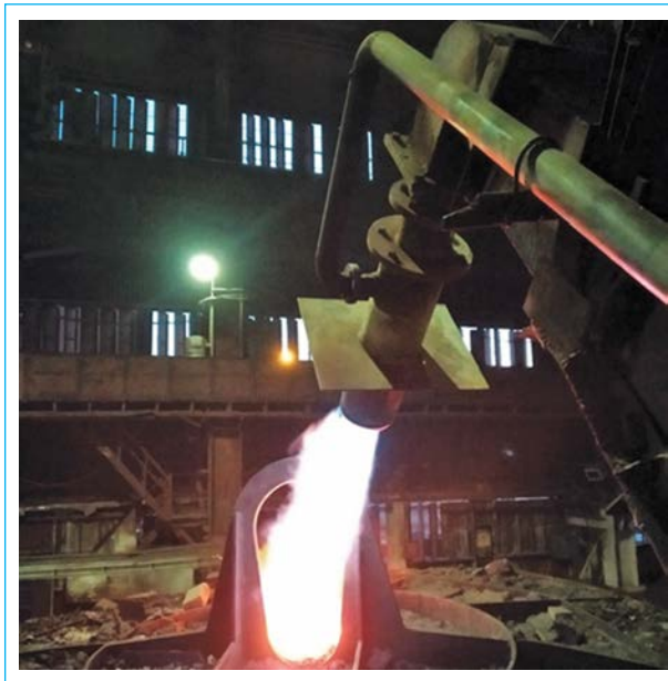
Газовий швидкісний пальник ГНБ-1500 в робочому стані перед зануренням у 250-тонний ківш
